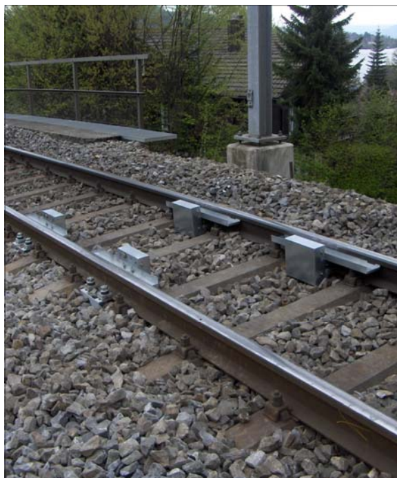
Kurvenschmieranlage in Hergiswil: Zurzeit werden die Auswirkungen gemessen.
